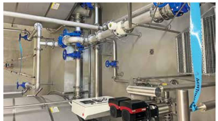
Die Technik des Hochbehälters.
